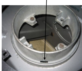
So sieht der fertige Kondensatablauf aus.
